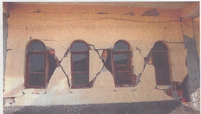
Figure 18. Fissuration en croix des murs en maçonnerie, séisme d'Adana, Turquie 1998 (Photo : P. Balandier).
