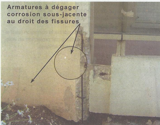
Figure 17. Toutes les armatures corrodées doivent être dégagées (crédit photo : société Parexlanko).
