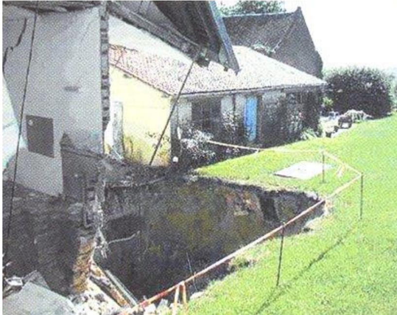
Figure 20: Effondrement de terrain (fontis) en zone pavillonnaire (document BRGM).
