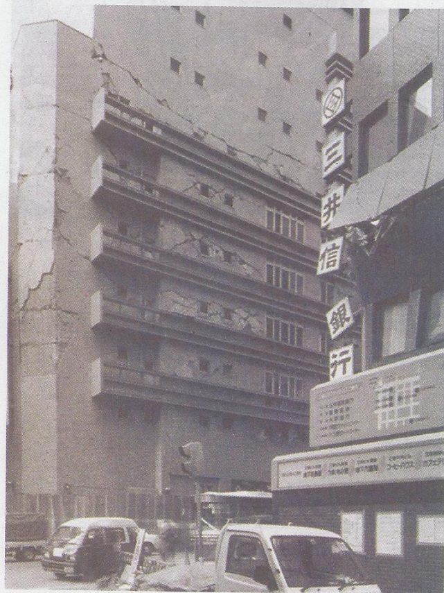
Figure 28. Fissuration des murs en béton, séisme de Kobé, Japon 1995 (Photo : R. Miyamoto).
