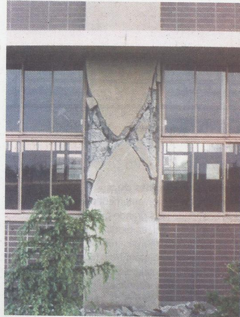
Figure 9. Cisaillement d'un poteau « bridé » par des allèges en béton, séisme de Tokachi-Oki, Japon 1968 (Photo : K. Takeyama, photothèque de l'AFPS).
