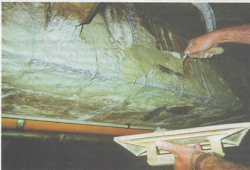
Figure 22. Mise en place de mortier de réparation à la truelle (crédit photo : société Parexlanko).
