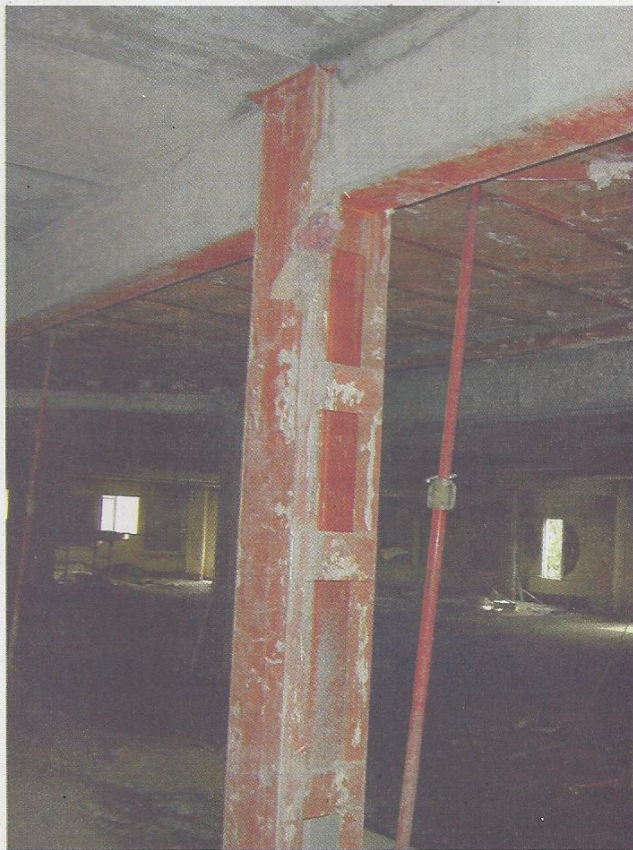
b) Plaque collée en sous-face de la poutre
