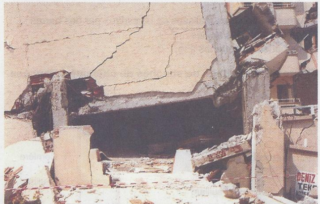
Figure 30. Éclatement des panneaux de remplissage en maçonnerie suivi de l'effondrement de l'immeuble, séisme Ceyhan-Misis, Turquie 1998 (Photo : P. Balandier).
