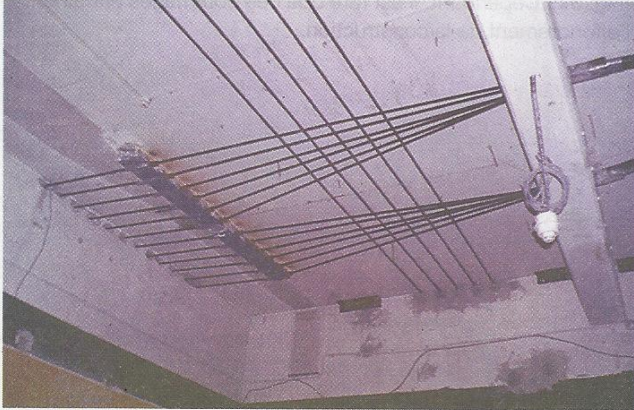
a) Câbles de précontrainte sous dalle
