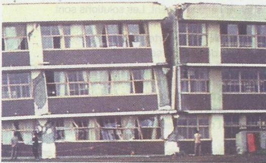
Figure 12. Dommages dus à l'entrechoquement de blocs d'un bâtiment fractionné, séisme de Tokachi-Oki, Japon 1968 (Photo : K. Takeyama, photothèque de l'AFPS).
